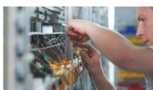
Raccordement au réseau
