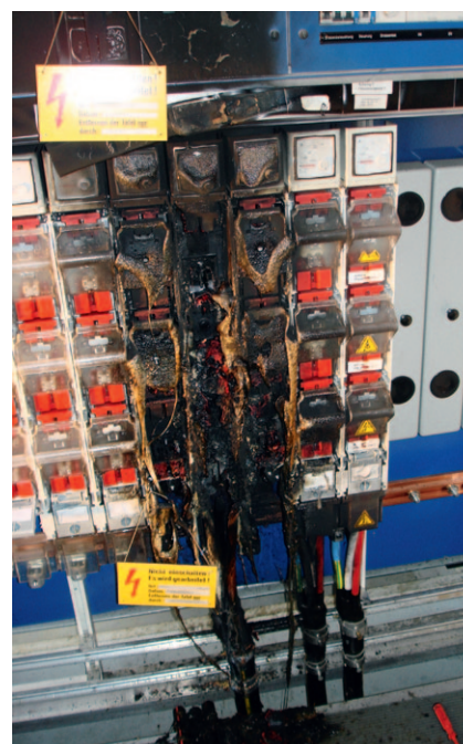
Schaden durch Kurzschluss beim Arbeiten; Person schwer verletzt.
