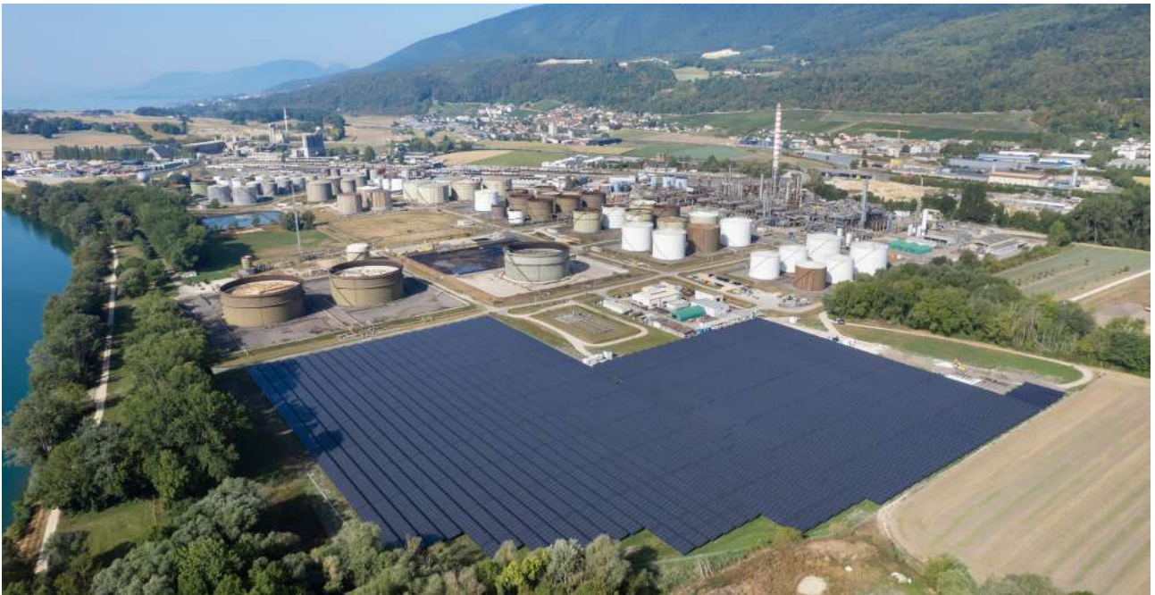
Le parc solaire le plus puissant de Suisse est mis en service à Cressier (NE) en septembre 2023.
