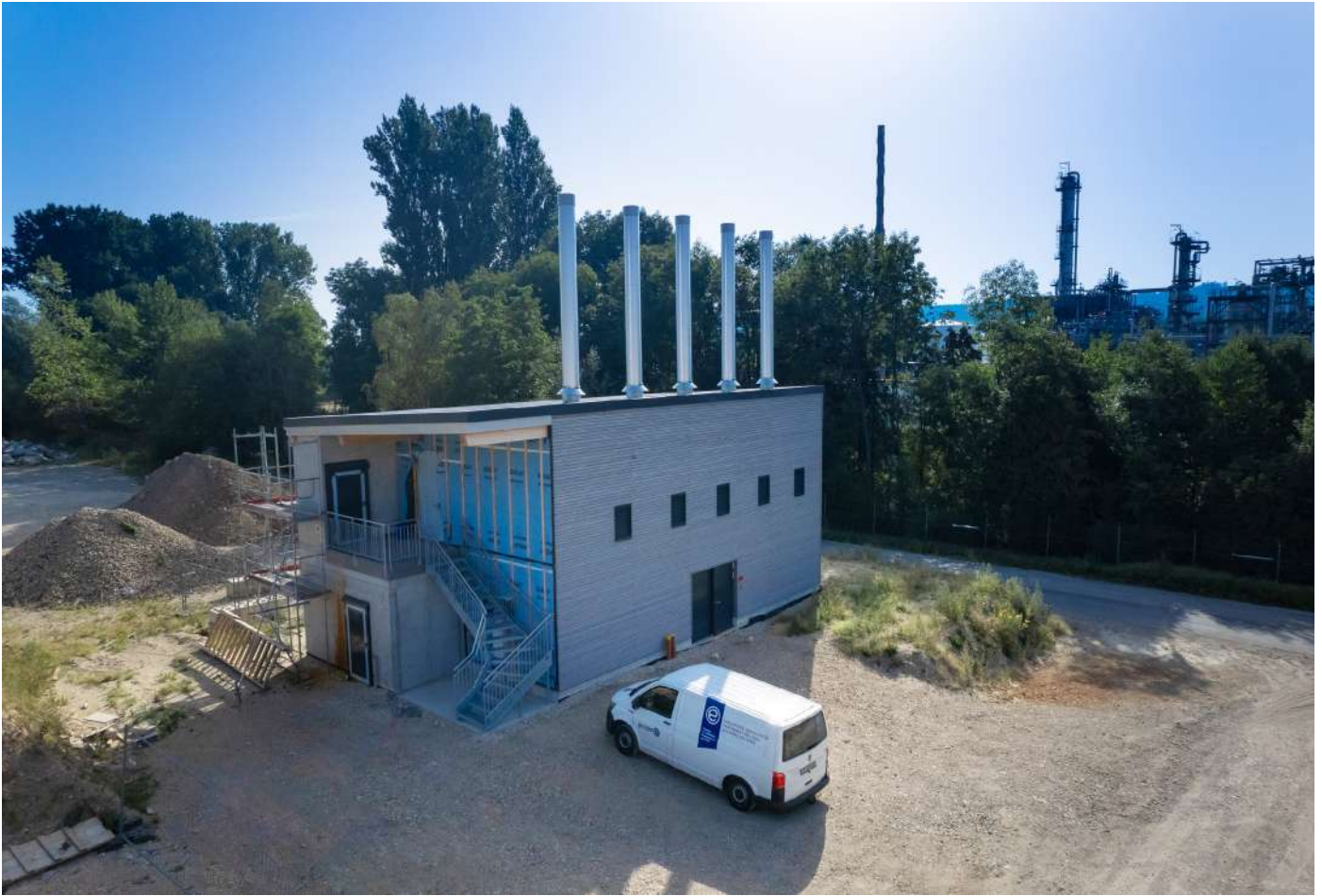
Notfallzentrale der Fernwärmanlage Entre-deux-Lacs
